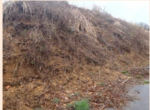
【農地法面の掘り起こし被害】
