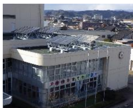
公共施設に設置した太陽光パネル
