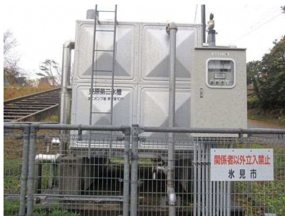
図 6.3.4 北八代第二配水場
