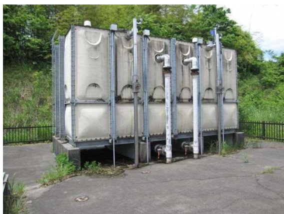
図 6.3.3 上田工業団地配水場
