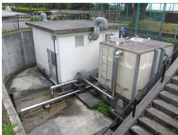
図 6.3.2 北部第二配水場
