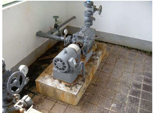
図 6.8.2 北八代第一加圧場
