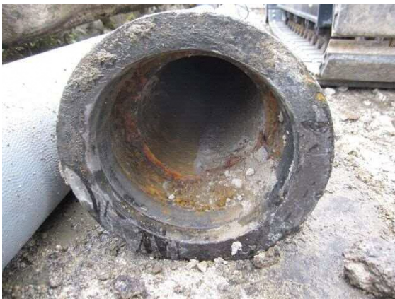
図 6.5.1 使用していた配管
