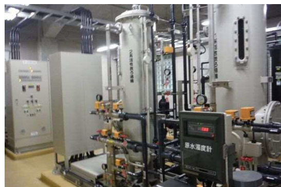
図 2.2.7 赤毛浄水場のろ過装置
