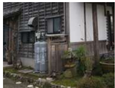
板塀により直接露出しないよう目隠しされたガスボンベ
