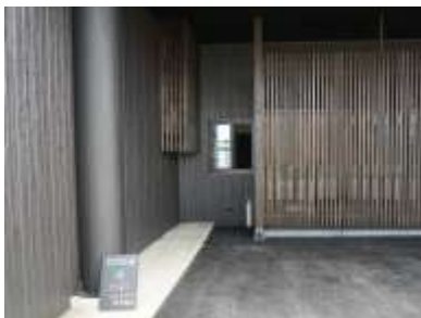
ルーバーで修景した建築設備
