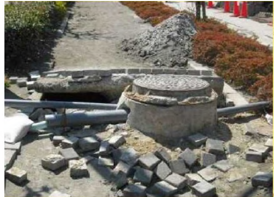
マンホールの浮き上がり
