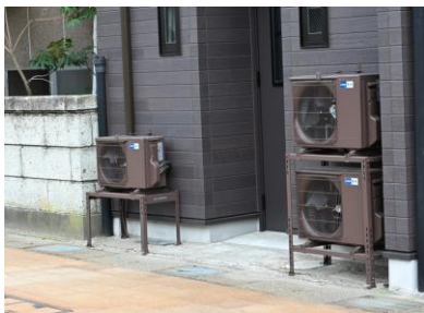
建築物と調和した色彩に修景された建築設備
