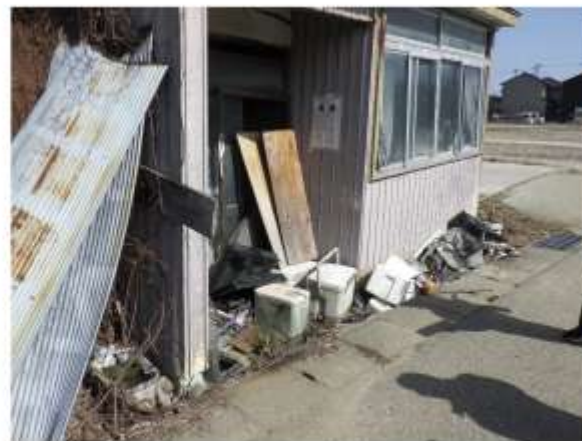
⑭家屋の沈下の状況
