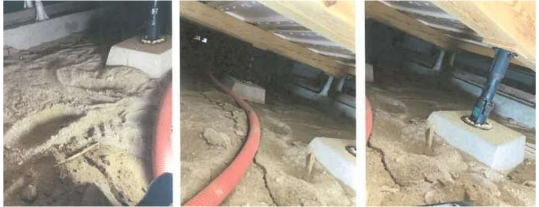
⑲家屋内の噴砂の状況
