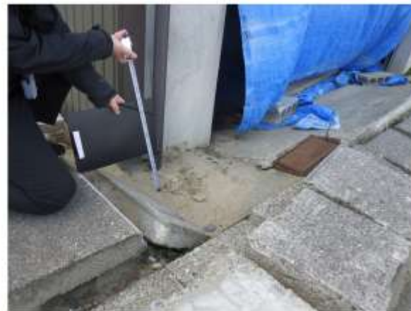
⑤家屋の沈下・破損の状況
