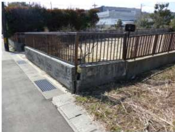
③地盤の沈下に伴うフェンスの基礎の沈下・破損の状況
