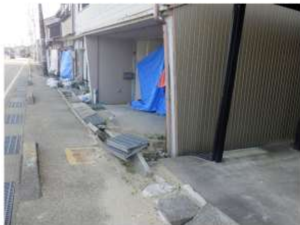
⑦家屋の沈下・側溝破損の状況
