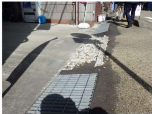
②家屋及び敷地地盤の沈下状況
