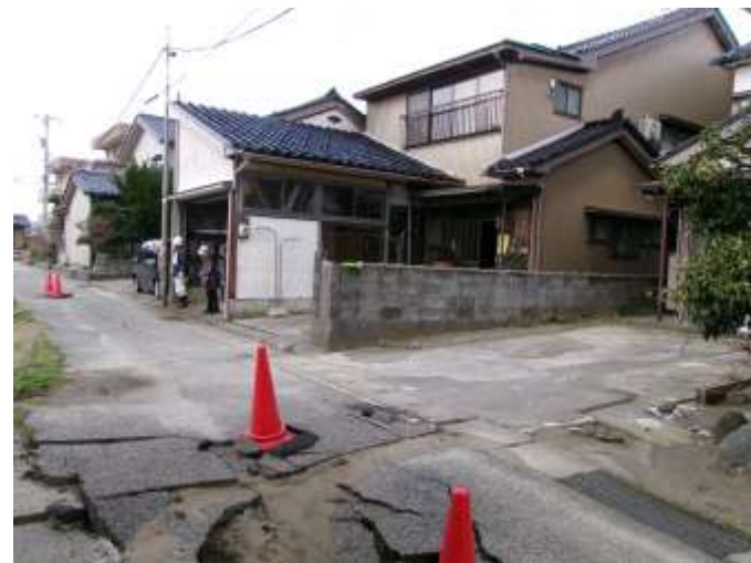
㉑道路の陥没及び噴砂の状況
