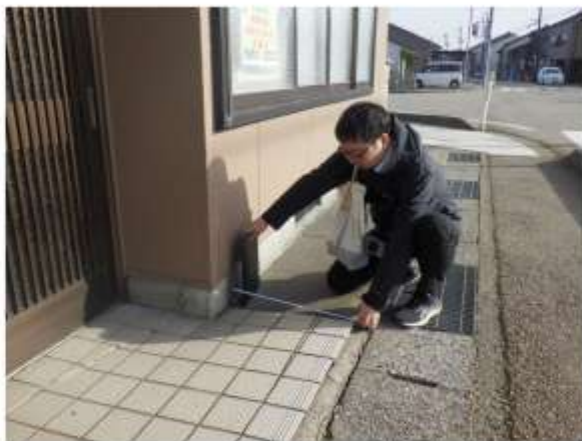
⑨家屋沈下の状況
