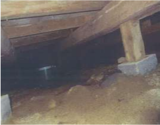
⑱家屋内の噴砂の状況
