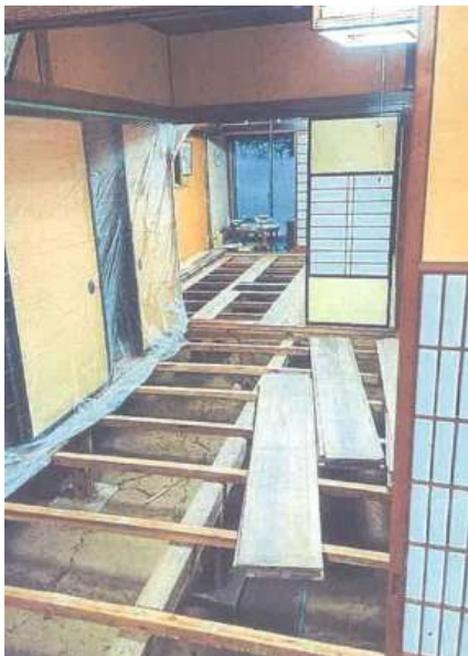
⑳家屋内の噴砂の状況
