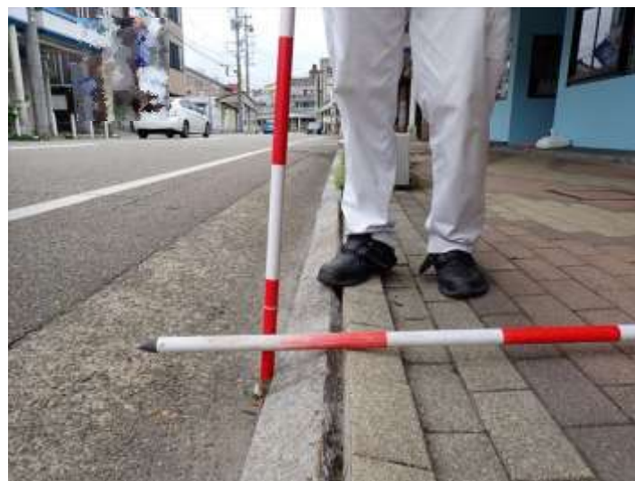
街渠沈下、縁石浮き上がり（写真2次-15）
