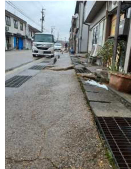
側方流動とみられる 歩道端部における舗 装盤の隆起
