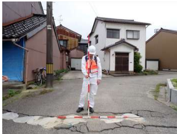
アスファルト舗装の損傷（写真2次-22）
