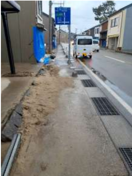
官民境界部における 噴砂の状況 (段差＋噴砂)
