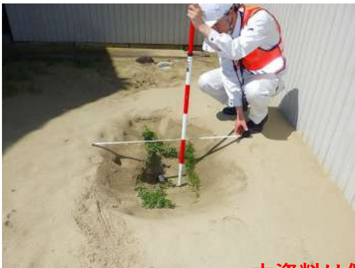
宅地地盤の陥没・噴砂（写真1次-31）
