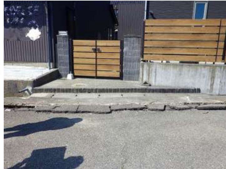
縁石の浮き（写真1次-2）
