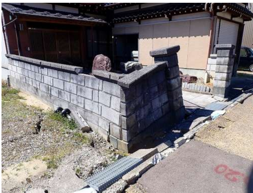
ブロック塀破損、側方流動による側溝圧壊
