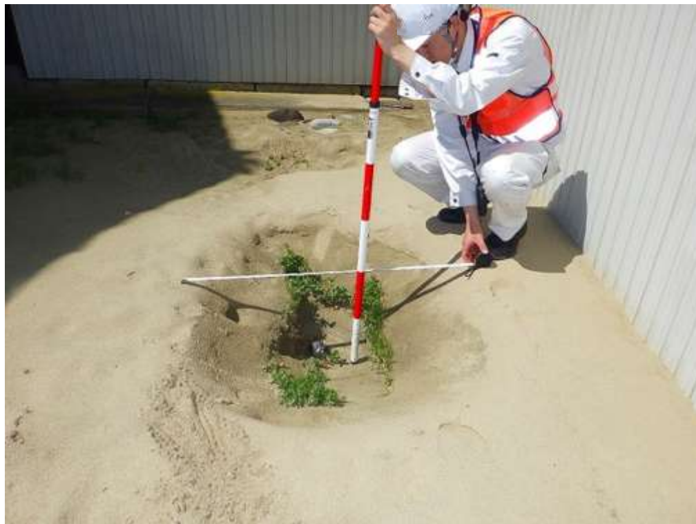
宅地地盤の陥没・噴砂（写真1次-31）
