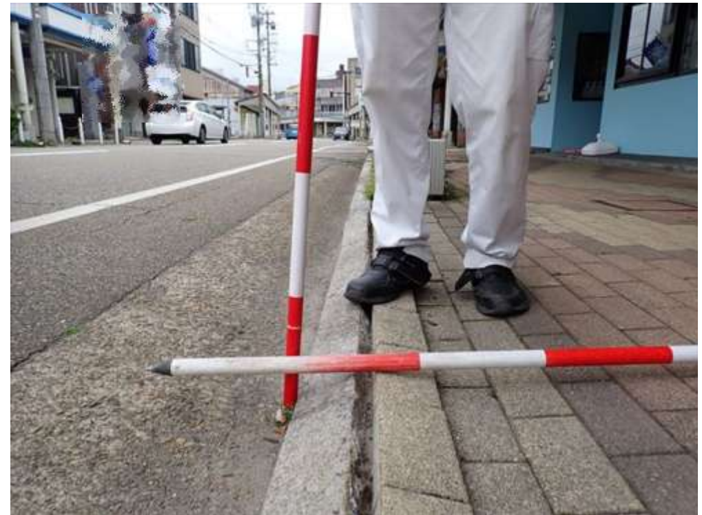
街渠沈下、縁石浮き上がり（写真2次-15）
