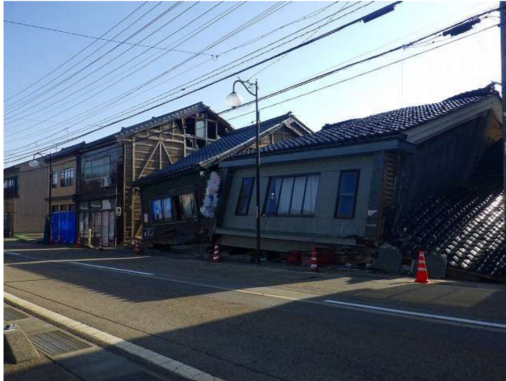
家屋の倒壊（写真2次-135）
