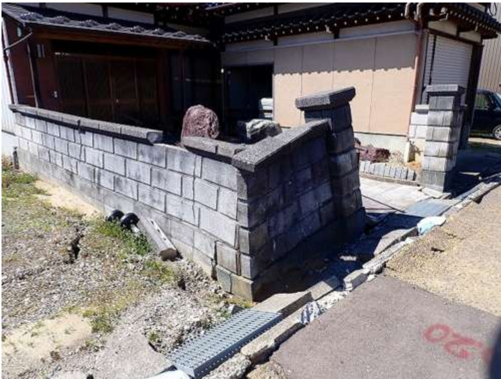
ブロック塀破損、側方流動による側溝圧壊（写真1次-151）
