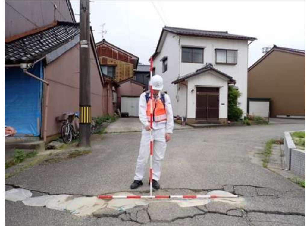
アスファルト舗装の損傷（写真2次-22）
