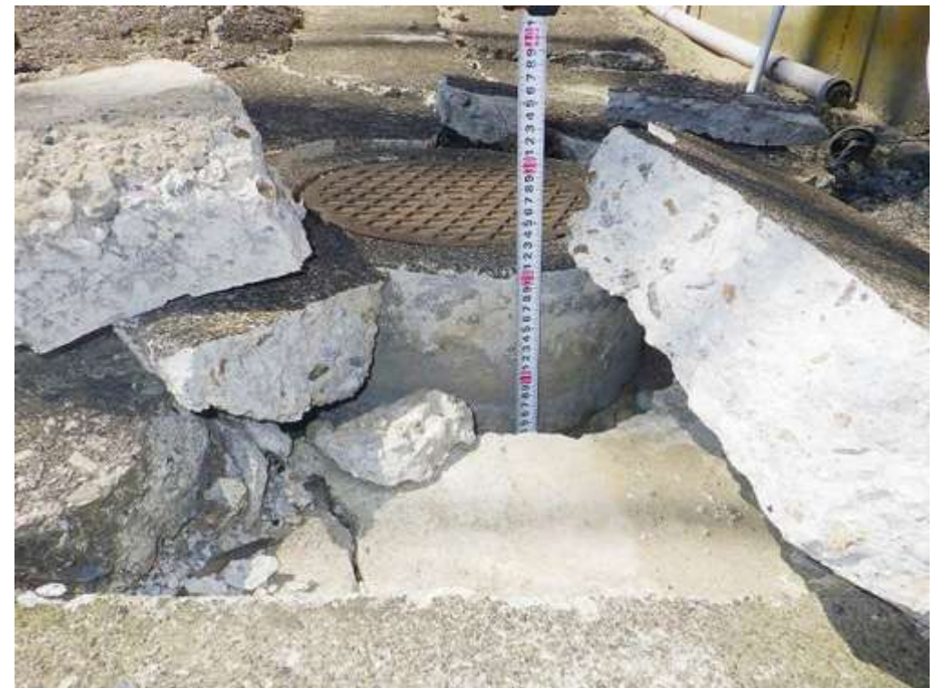
下水道マンホール周辺のコンクリート損壊（写真1次-20）
