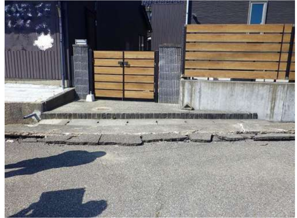
縁石の浮き（写真1次-2）
