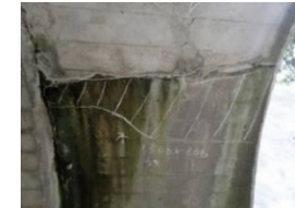
トンネルの「うき・ひび割れ」(対策を要する損傷、変状例)
