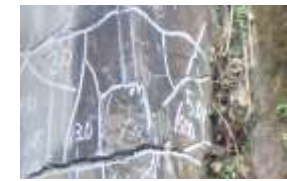
コンクリート橋のひび割れ
