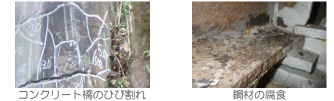
コンクリート橋のひび割れ 鋼材の腐食 (対象橋梁の対策を要する損傷例)
