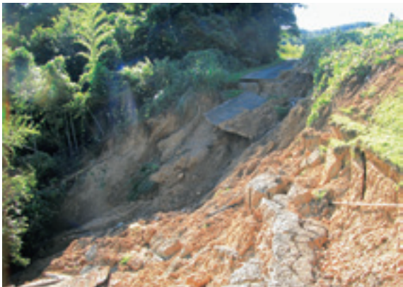
豪雨による市道北山光西寺線道路の地すべり (平成25年8月25日撮影)
