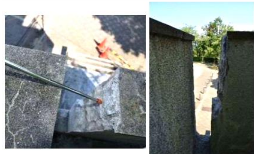
外壁スリット モルタル剥落
