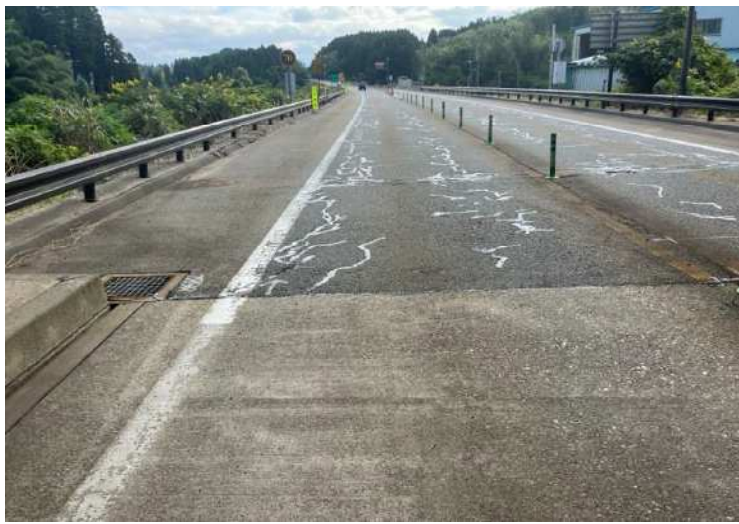
舗装の損傷状況
