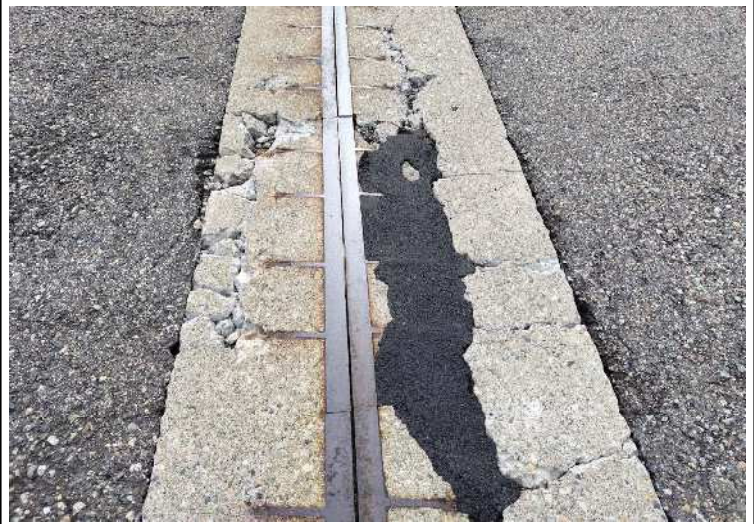
橋梁の損傷状況
