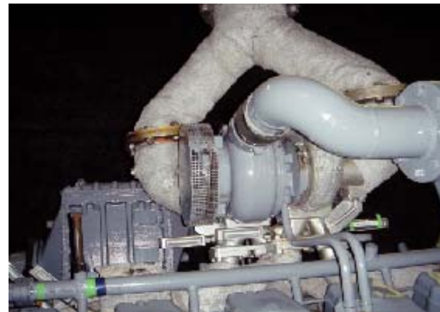
配管エルボの保温材②
