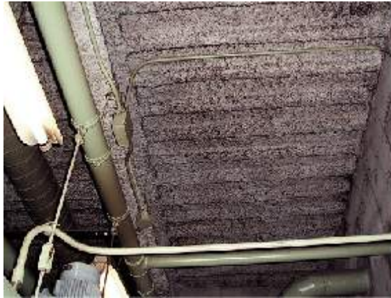
天井断熱材 天井、壁吸音材
