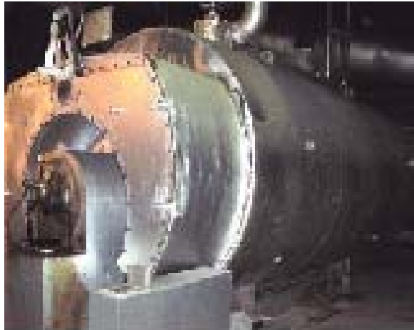
ボイラー の保温材
