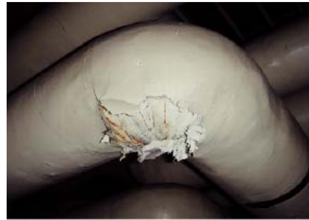
配管エルボの保温材①
