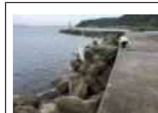
消波ブロックの沈下状況
