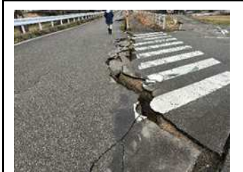
市道の被災状況
