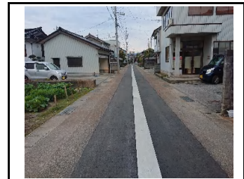
更新した消雪パイプ
