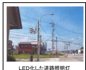
LED化した道路照明灯
