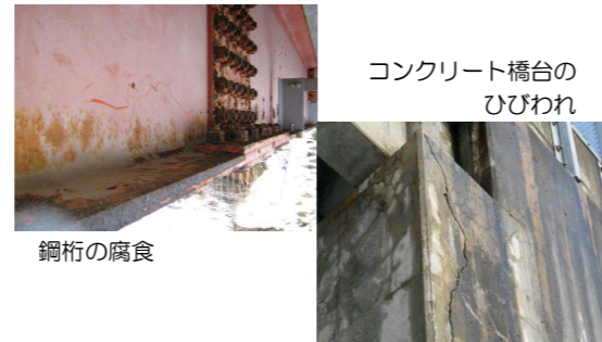
<点検によって発見された損傷例>
